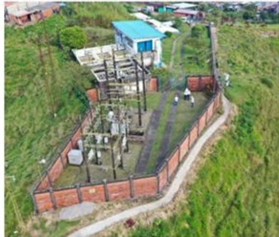
*Vista aérea Subestación Samaná (Samaná – Caldas)
