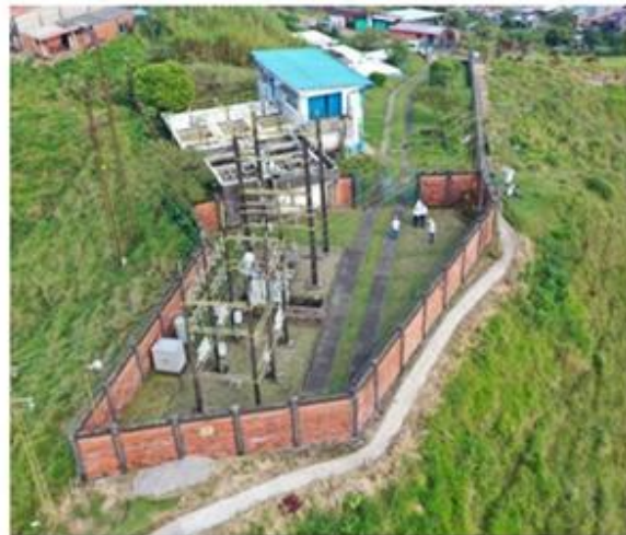
*Vista aérea Subestación Samaná (Samaná – Caldas)
